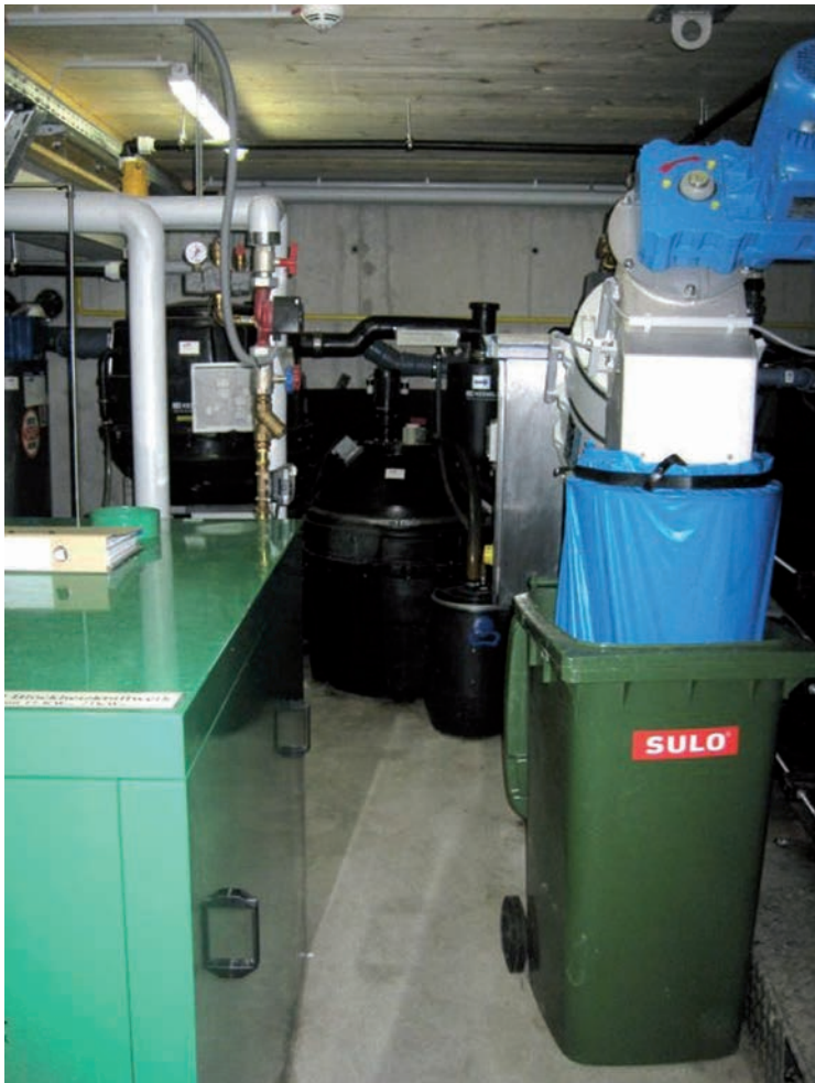
Abbildung 26: Energiever- (Blockheizkraftwerk – BHKW) und Abfallentsorger (Feststoffpresse) im Maschinenraum der Oppererhütte/Tuxer Hauptkamm, eine Musterhütte der Alpenvereine.
