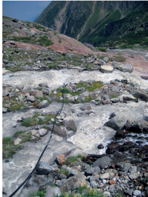
Abbildung 29: Die Wasserleitung der Sulzenauhütte in den Stubaiern verläuft durch grobes Geröll und besteht aus robustem Rohrleitungsmaterial.
