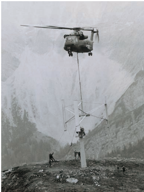
Abbildung 9: Bei der Installation des Rotwandhaus-Windrades im Oktober 1990. Es arbeitete Jahrzehnte lang zuverlässig und sorgte auch für viel Energie – für die sich jedoch keine ausreichend dimensionierten Batteriespeicher fanden.
