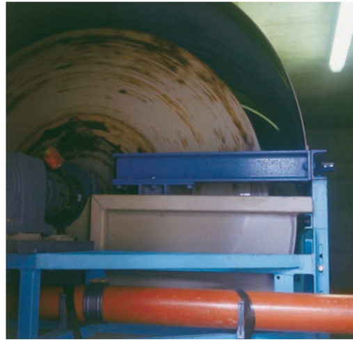
Abbildung 8: Scheibentauchkörperanlagen dienen der Abwasserreinigung und gehören zu den Hauptreinigungssystemen. Zersetzende Mikroorganismen werden durch langsame Rotation abwechselnd mit dem Abwasser und mit der Luft in Kontakt gebracht.
