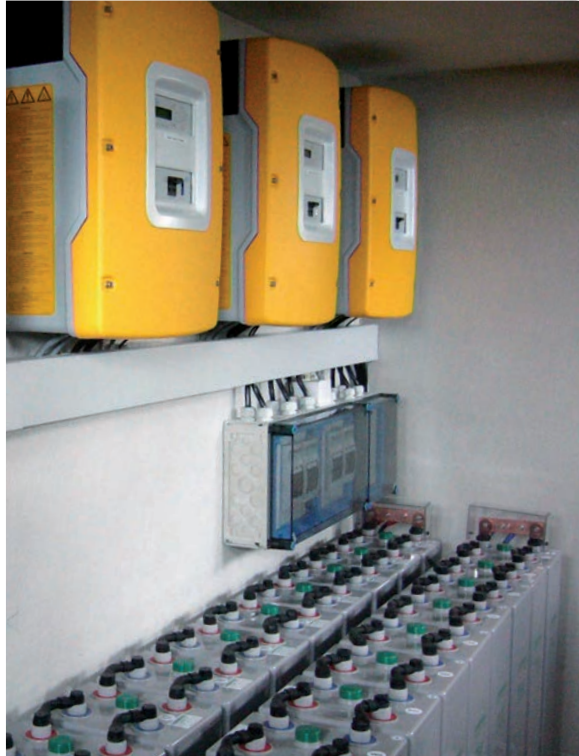
Abbildung 25: Gutes Batteriemangement ist Voraussetzung für eine lange Lebensdauer eines Batterieverbands; regelmäßige und ausreichende Vollladung muss sichergestellt sein.
