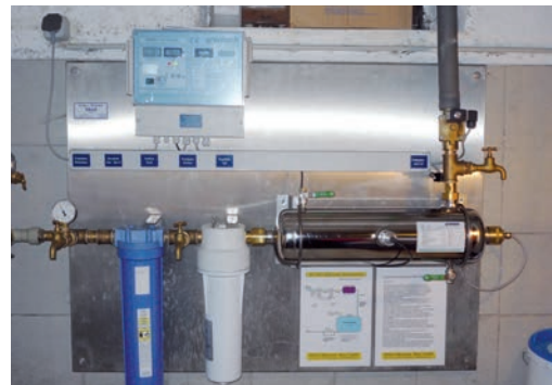
Abbildung 42: UV-Desinfektionsanlagen dienen der weitergehenden Abwasserreinigung; hier die Anlage im Bodenschneidhaus/Bayerische Voralpen.
