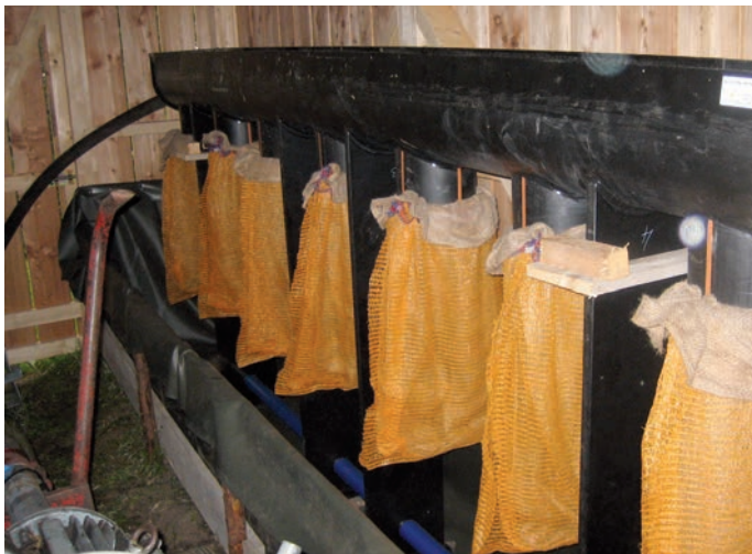
Abbildung 44: Die Filtersack- anlage der Ostpreußenhütte in den Berchtes- gadener Alpen; solche Anlagen dienen der Ab- wasservorreini- gung als auch der Schlamm- entwässerung.
