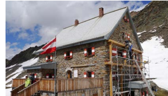
Baufälliges Hochwildehaus aufgrund tauendem Permafrost. Foto: DAV
